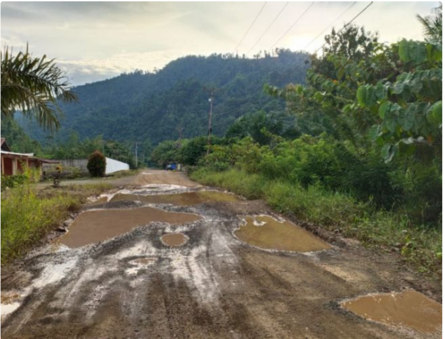
Tampak jalan poros Bimorjaya Mirip Kubangan Kerbau
